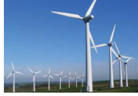
I. Rüzgâr türbini
